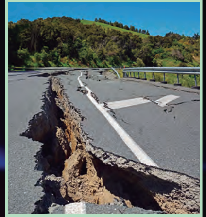
Daños en caminos y estructura vial
