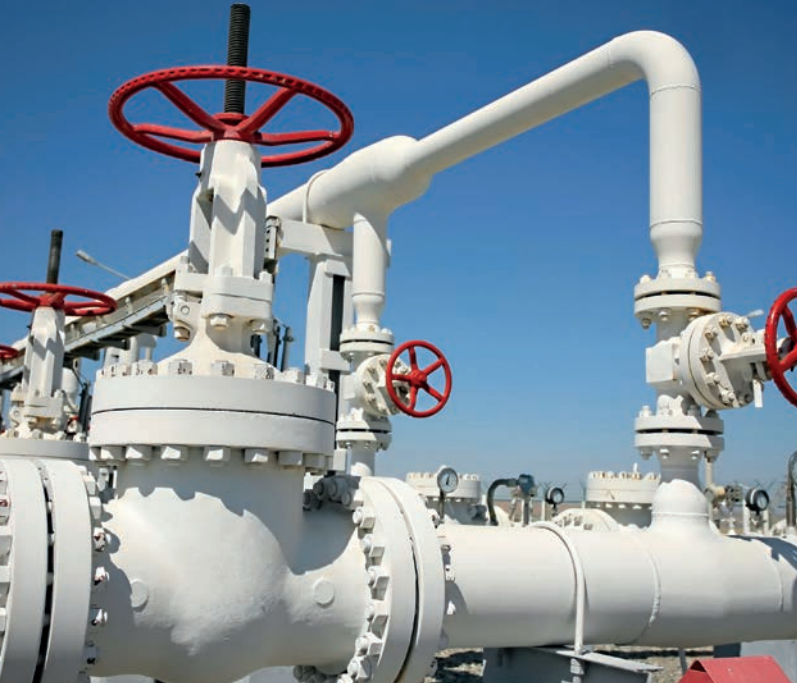
▲ Cañerías de gas natural.
