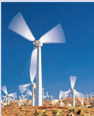
↑ Aerogeneradores para producir energía eólica.
